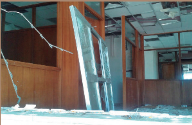
Vidres trencats, sostre després i portes arrancades a l'interior de l'immo- ble.
