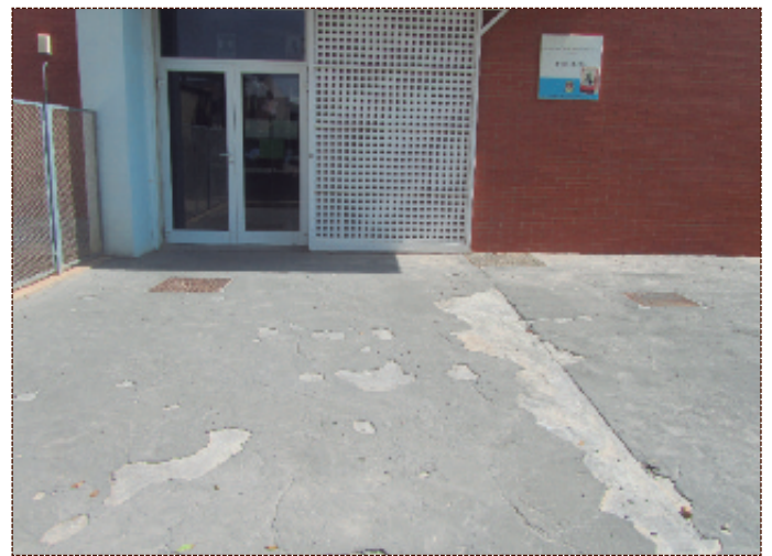
Accés a l'escola infantil municipal, amb l'asfalt ple de clots.
